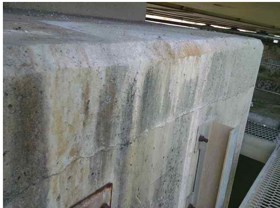
P8 코핑부 균열(폭 0.2mm)
